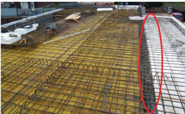
Obr. 5, 6 Podstojkovanie balkóna (tu vzniká výrazný tepelný most - betónová vrstva je neprerušená smerom k exteriéru)
